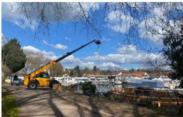
Changement des pontons défectueux
