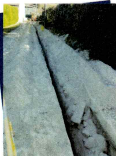
DEVOIEMENT DE L'HYDRAULIQUE PERRIERES SAINT MARTIAL DE VALETTE
