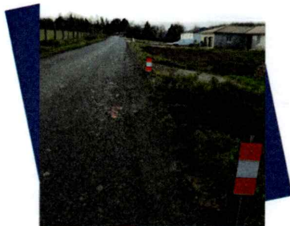
DEVOIEMENT DE L'HYDRAULIQUE LA MALADRERIE SAINT MARTIN LE PIN
