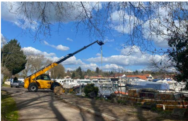
Changement des pontons défectueux
