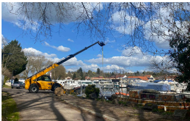
Changement des pontons défectueux
