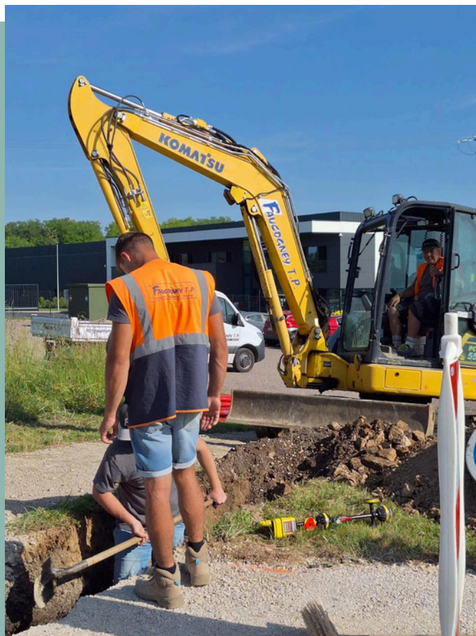
Travaux de terrassement réalisés par l'entreprise Faucoigny TP devant la société RFPM
