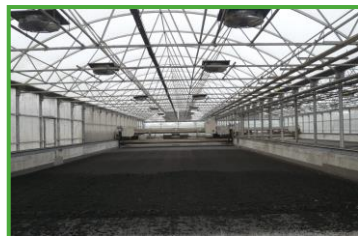
Serres de séchage des boues
