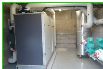
Pompe à chaleur
