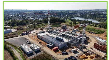
Usine des Eaux – octobre 2024
