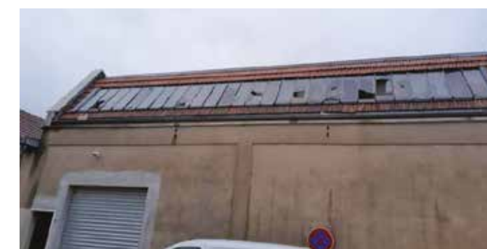
Toit du boulodrome grêlé
