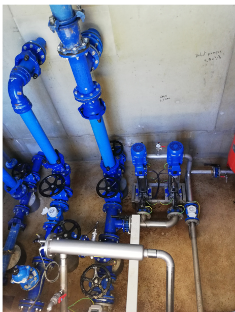
Chambre à vannes du réservoir d'eau potable de Glainans
