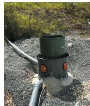
Réserve d'eau de 10 000 litres Alimentée par une source aux ateliers des services techniques de la Ville, elle permet le nettoyage de la commune et l'arrosage des plantations.
