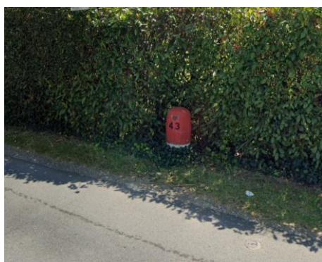
Ouvrage de défense incendie localisé à proximité du site
