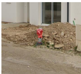
Ouvrage de défense incendie localisé à proximité du site
