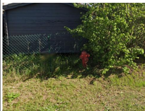
Ouvrage de défense incendie localisé à proximité du site
