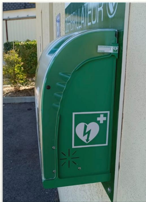
Maintenance réalisée sur les défibrillateurs de la commune
