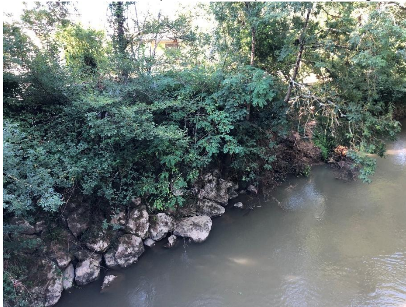
Vue depuis le pont : l'empierrement et le talus affaissé.
