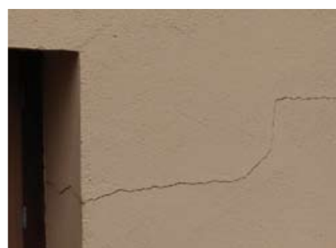
Fig. 1 : Fissure dans le mur d'une villa fondée sur les marnes du Lias (rue du Château d'eau).
