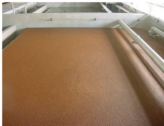
Vue d'un flottateur en fonctionnement
