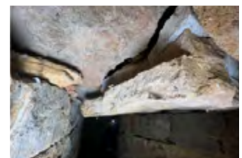
Fracture et affaissement des dalles
