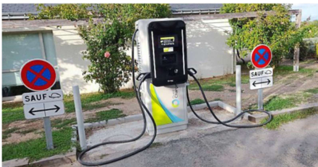
La borne de recharge électrique, avenue de la Loire.
