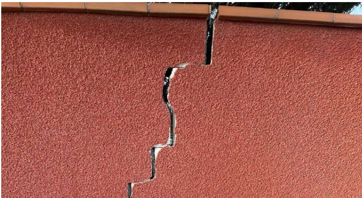
Illustration 126 : Mur fissuré en raison de mouvements de terrain induits par la rétraction et le gonflement du sol argileux (Photographie prise hors commune)
