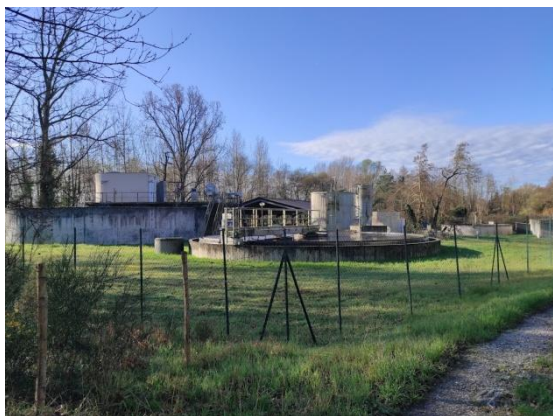
La station d'épuration de Castelnau
