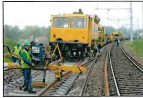
Longs Rails soudés sur traverses béton
