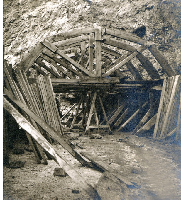
Galerie d'évacuation des eaux *
