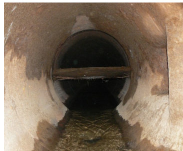
La conduite forcée
