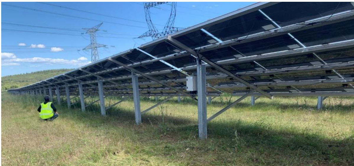
Figure 6 - Photographie d'un site en fonctionnement (source : Neoen)
