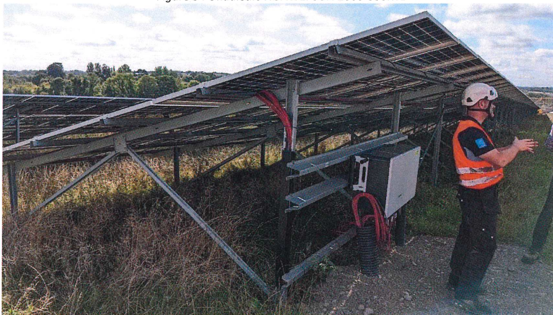
Figure 6 : Exemple d'installation d'un onduleur en dessous d'une table photovoltaïque
