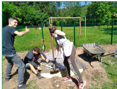
Pose de passages canadiens à la Munimotta, avec des jeunes du village, pendant l'été
