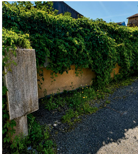
Végétation non entretenue
