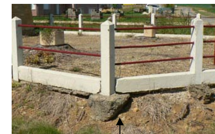
La dépose de la clôture et des fondations évitera érosion et nuisance de toute nature.
