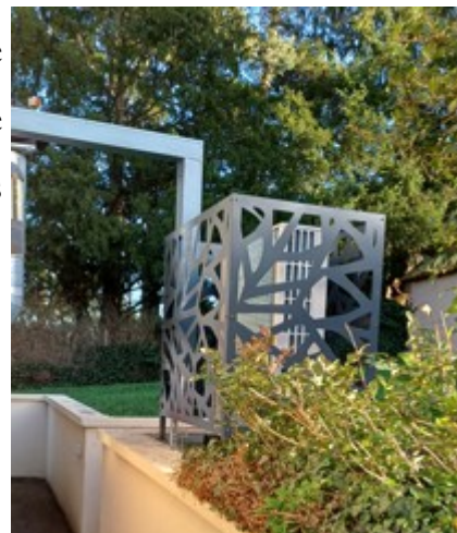
Pompe à chaleur
